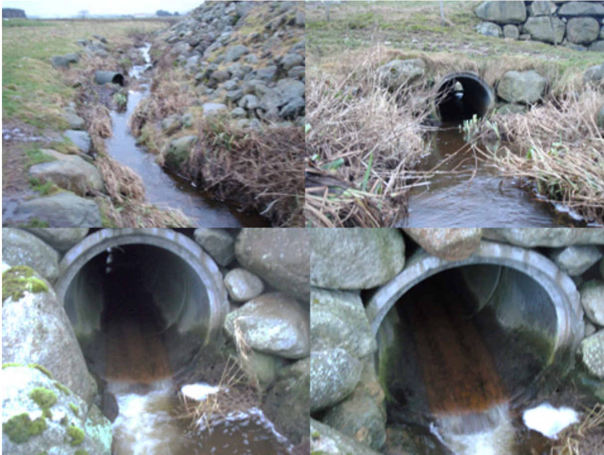
Figur 29. Grødalandsbekken, med kryssing under Fv 44 ved rund betongkulvert som ikke tilfredsstillende utført for fiskevandring.
