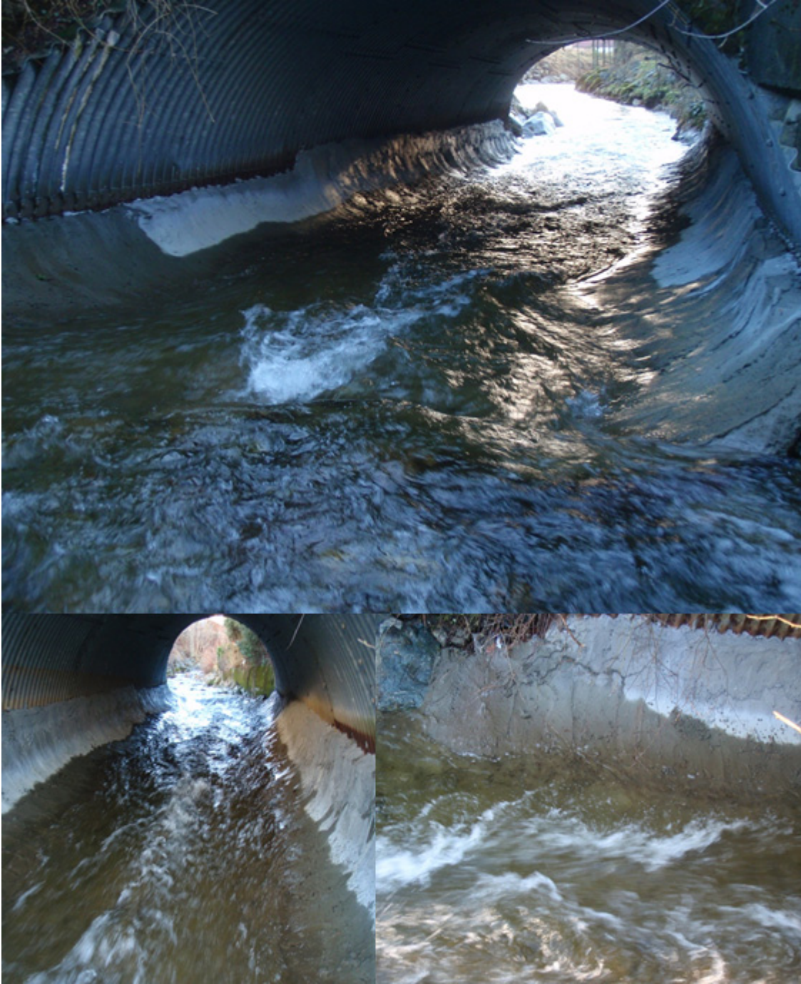
Figur 36. Kulvert under Rv 13 i Skardbekken.
