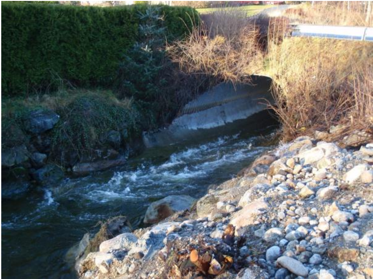
Figur 35. Kulvert under Rv 13 i Skardbekken.
