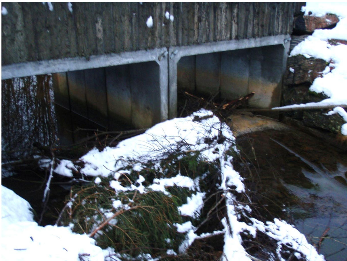
Figur 63. Delvis tett betongbruonstruksjon.
