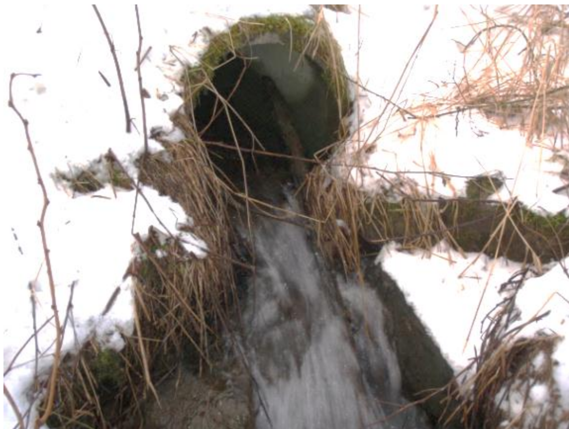
Figur 53. Svevende og underdimensjonert betongkulvert.
