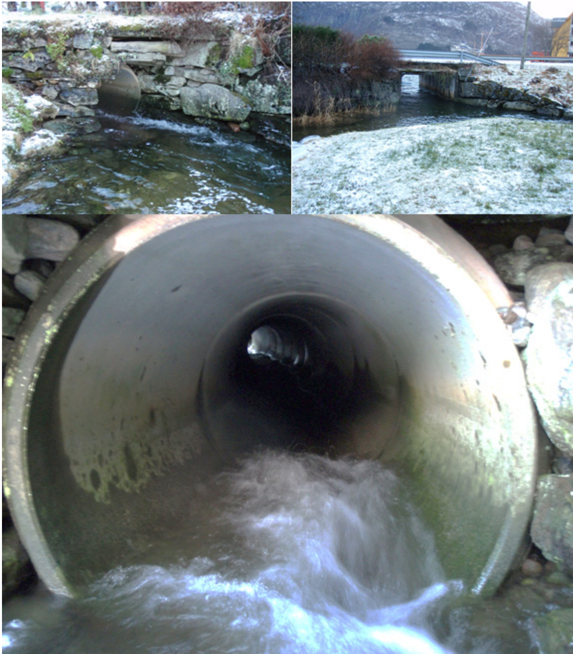
Figur 28. Nedre kulvert under boligområde (nederst og øverst t.h.) rett før munningsområde til Nitterelva (øverst til venstre).
