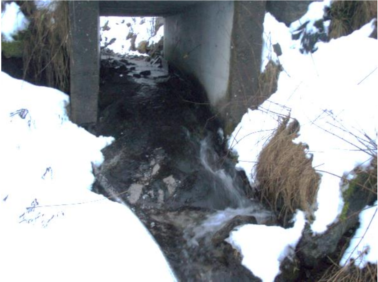
Figur 18. Kulvert under privat/kommunal vei har ført mer av bekken over glatt berg, noe som utgjør et hinder for oppvandrende gytefisk.
