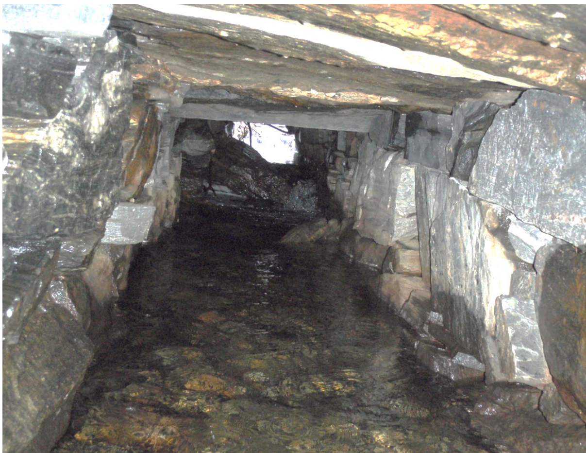
Figur 49. Kryssning under 542 har terskel midt under veien som er vanskelig å vurdere.
