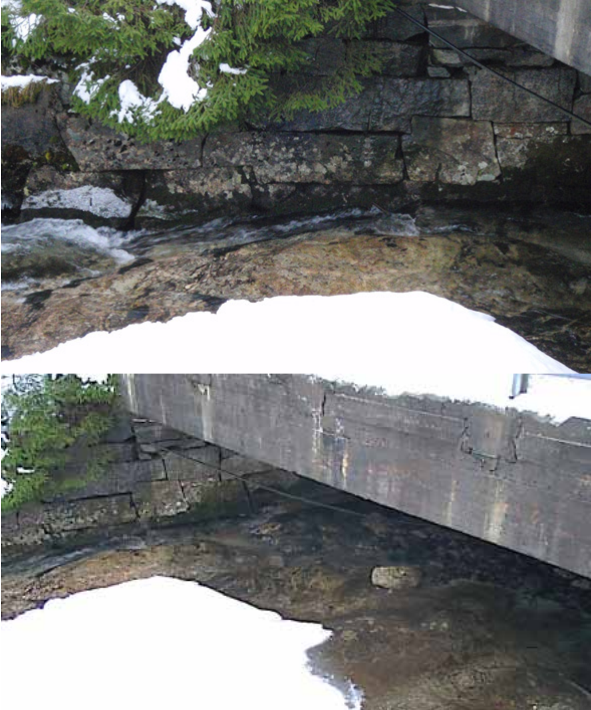
Figur 64. Eldre steinsetting kan ha ført elva over berg/fjell slik at fisk har vanskeligheter med å passere.
