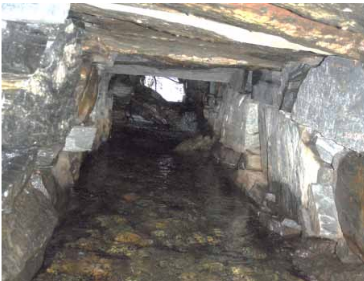
Figur 49. Kryssning under 542 har terskel midt under veien som er vanskelig å vurdere.
