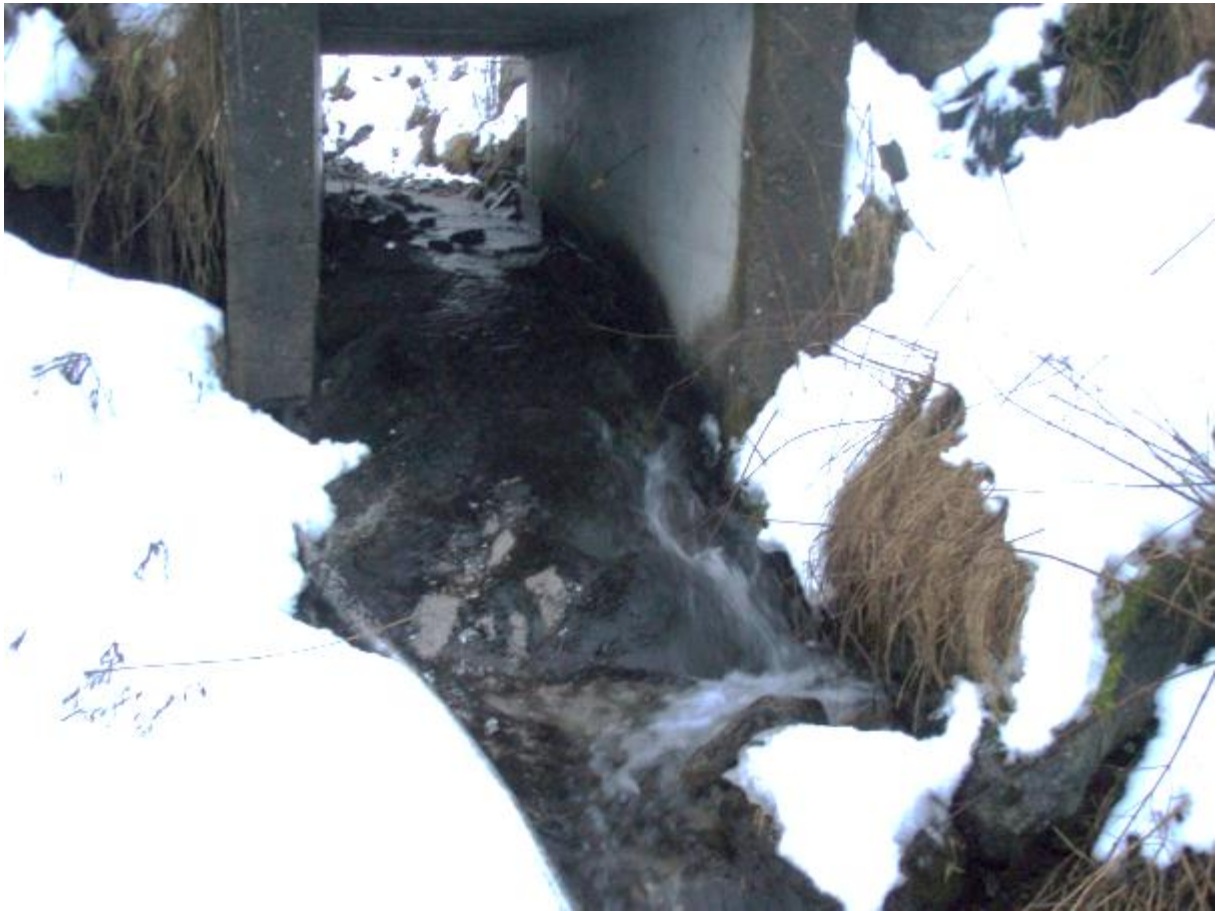
Figur 18. Kulvert under privat/kommunal vei har ført mer av bekken over glatt berg, noe som utgjør et hinder for oppvandrende gytefisk.
