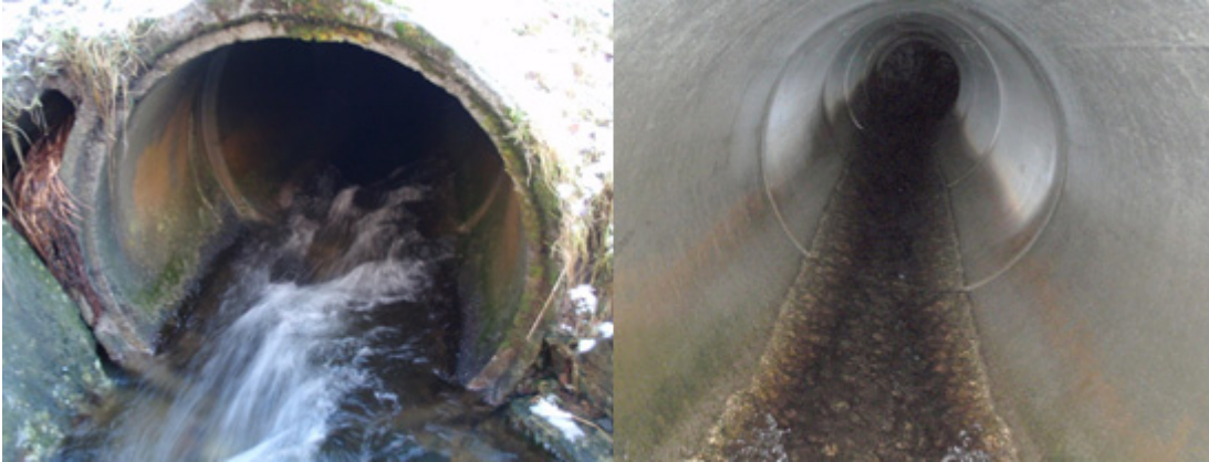
Figur 31. Kulvert under vei 57 og bensinstasjonsområdet.
