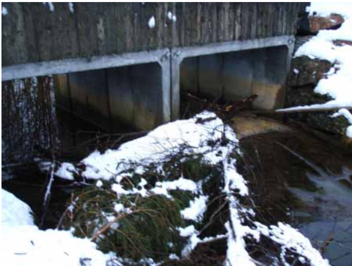
Figur 63. Delvis tett betongbrukonstruksjon.
