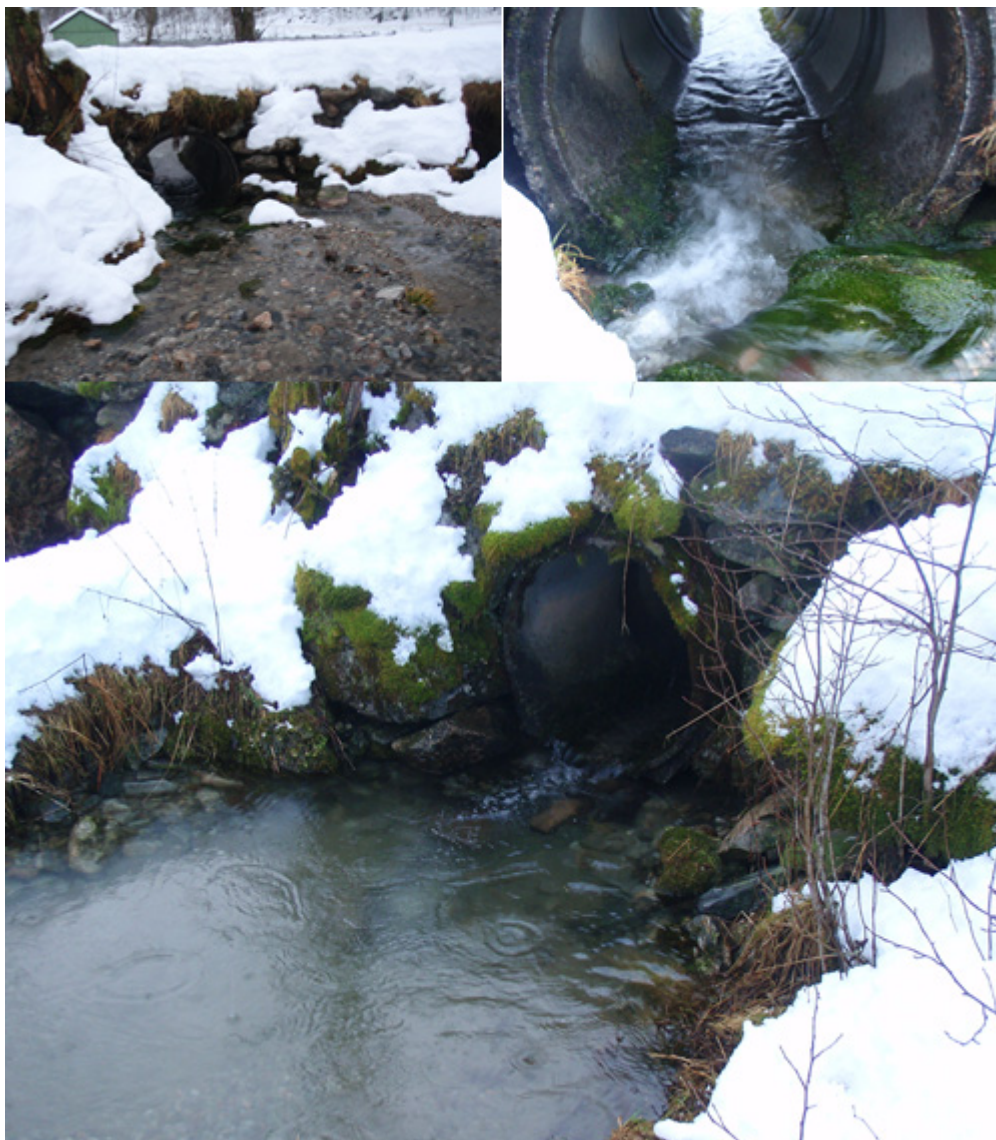
Figur 17. Kulvert under grusvei rett før munning til sjøen i Kaldebekken.
