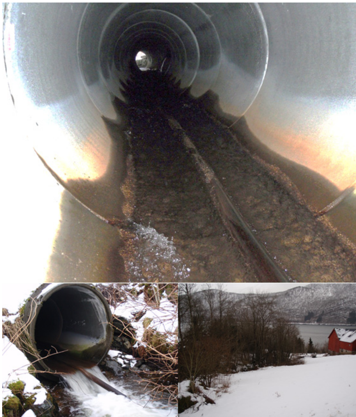
Figur 51. Kulvert under 39 (øverst og t.h.), men bratt terreng gir usikre naturlige oppgangsmuligheter i bekken.
