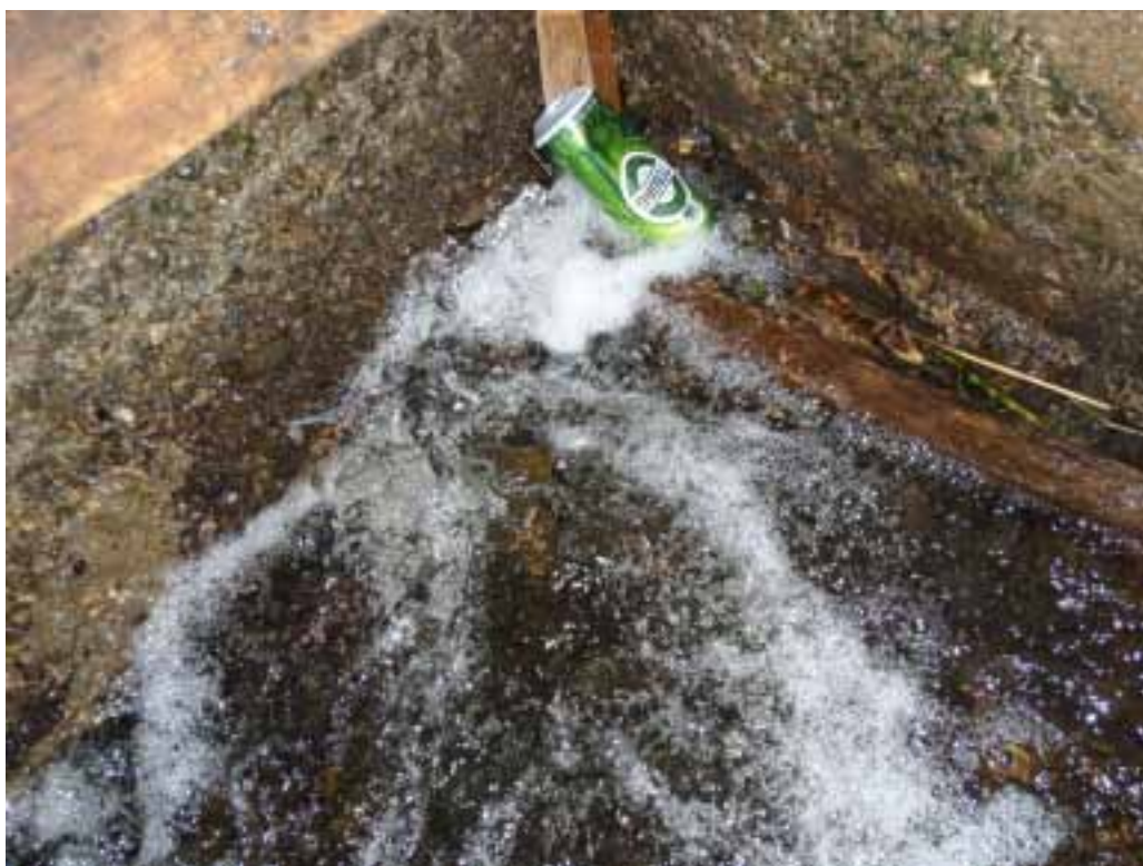
Figur 41. Betongkonstruksjon med for smal, tiltettet åpning, som vann skal renne gjennom.
