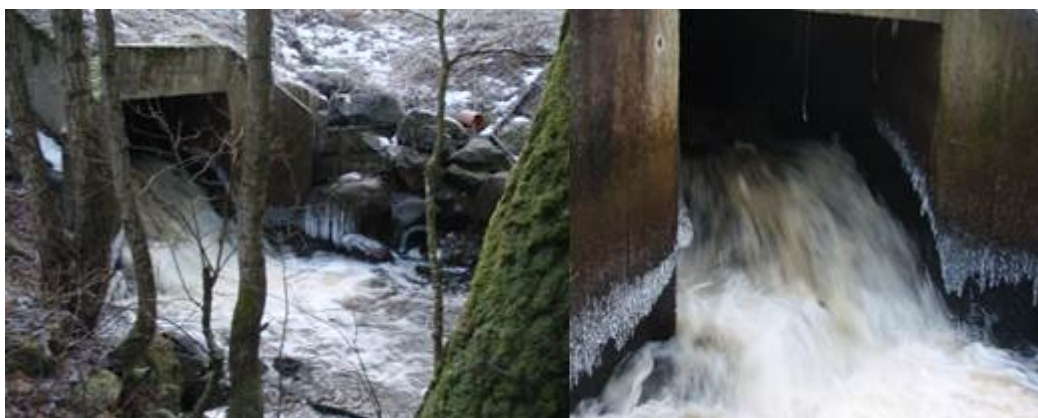
Figur 122. Kulvert under avkjørsel Bjørn Magnussons vei er sterkt vandringshindrende eller vandringsbarriere (8). Foto: NIVA
