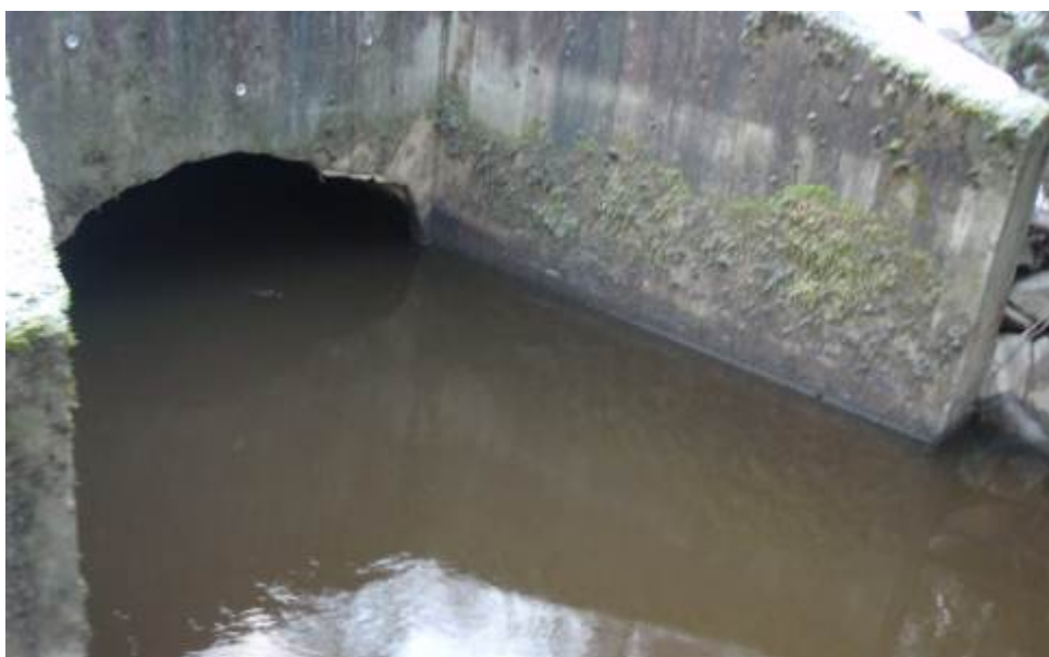
Figur 126. Krysning med senket, rund betongkulvert (13). Foto: NIVA
