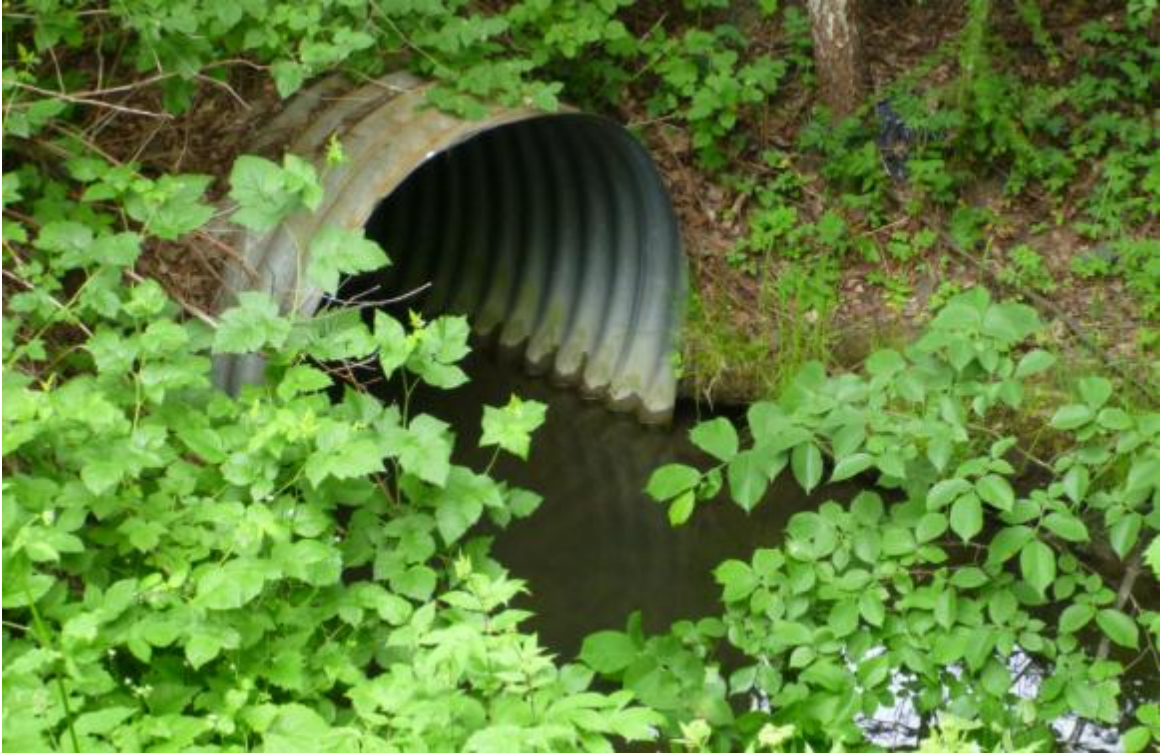
Figur 13. Godt nedsenket blikk-kulvert (3). Foto: NIVA
