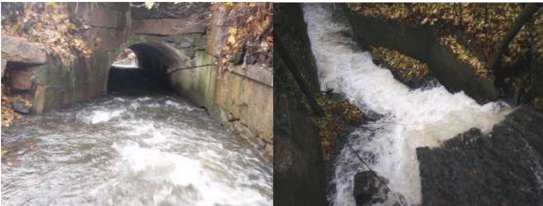
Figur 55. Krysning under Slemdalsveien (6). Et overheng (til høyre) av asfalt (?) skaper for høyt fall i forhold til det naturlige fallet, og hindrer evt. oppvandring av fisk i alle aldersklasser innad i avsnittet. Foto: NIVA
