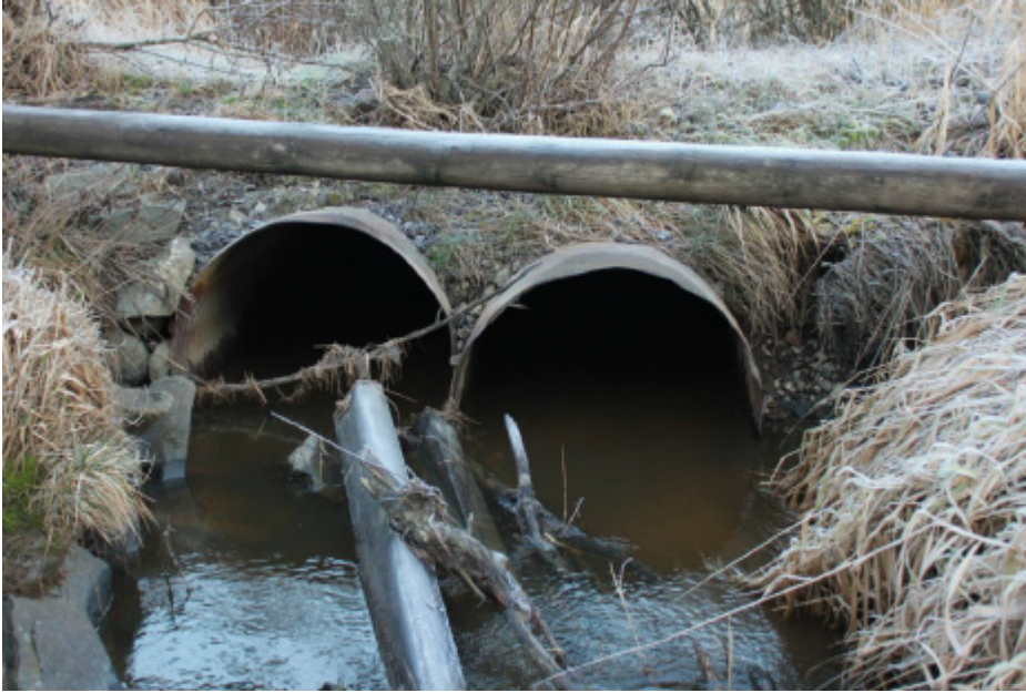
Figur 133. Godt nedsenket kulvert som ikke berører fiskevandring (8). Foto: Bymiljøetaten
