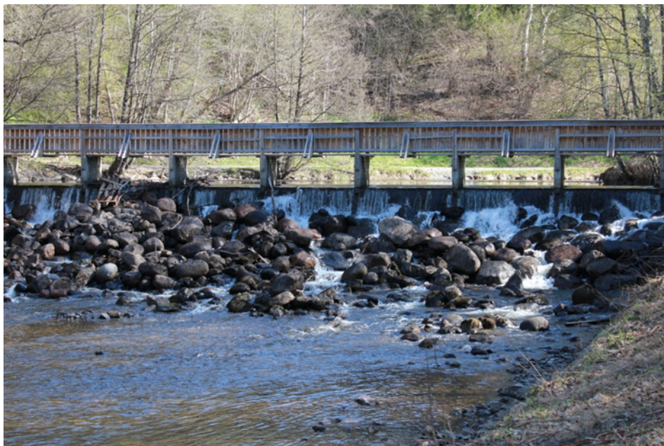
Figur 63. Grønvoldsterskelen i øvre del av Akerselva (22). Foto: Bymiljøetaten.
