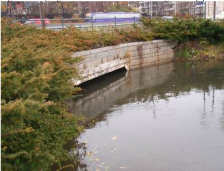
Figur 43. Frognerelvas utløp til sjøen. Godt nedsenket kulvert med tilfredsstillende dimensjon. Foto: NIVA
