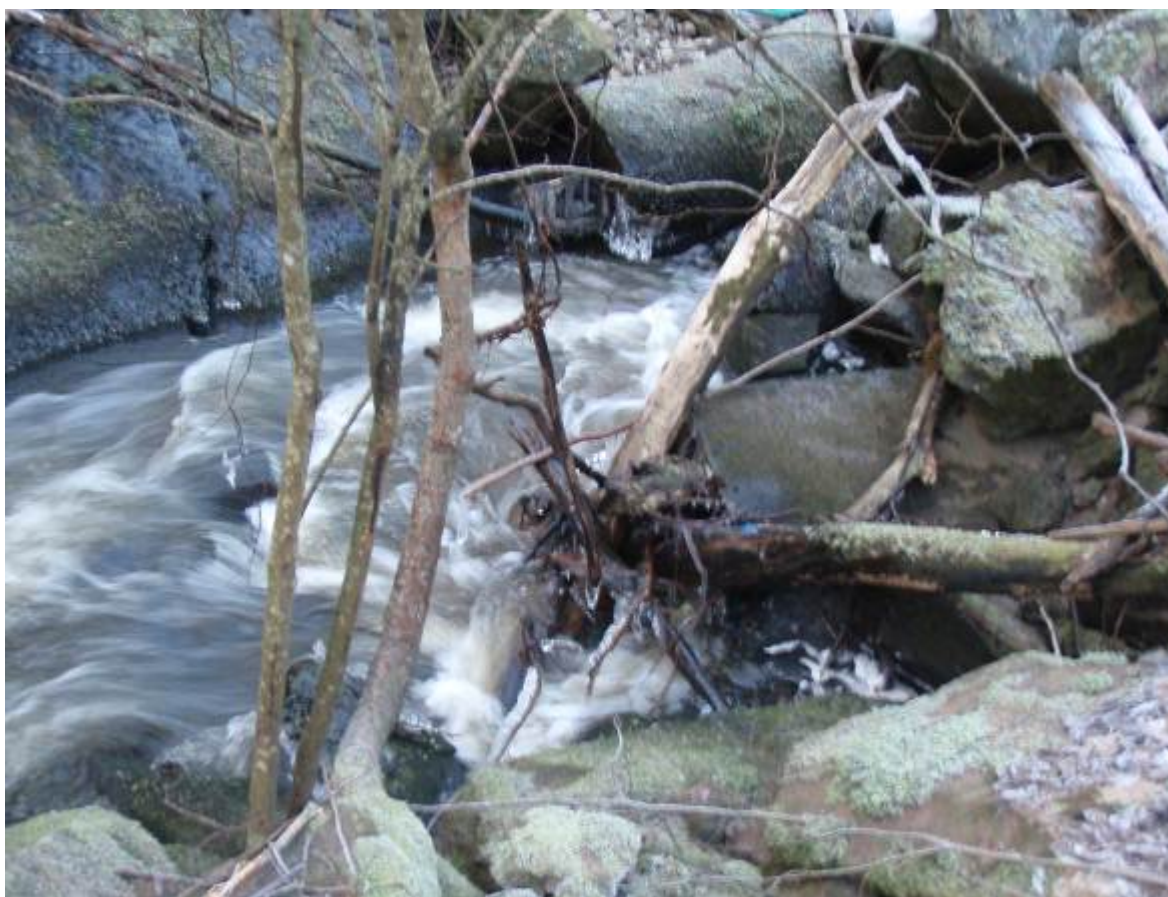
Figur 120. Innløp til kulvert, der hovedløpet er tiltettet. Flomløpet observeres svevende i bakgrunnen. Foto: NIVA
