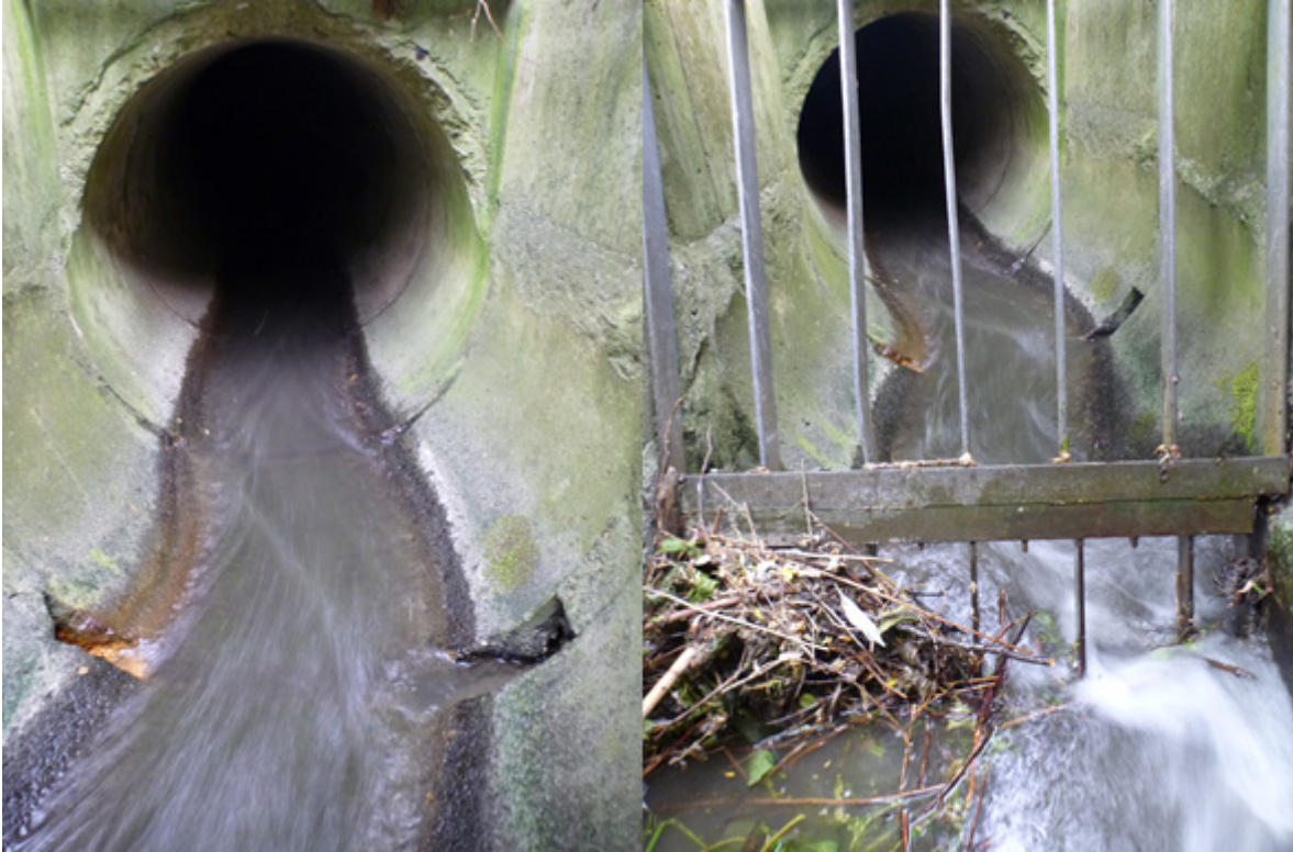
Figur 8. Videre nedover inngang under E 18 (1b). Dette partiet kan være kritisk for oppvandrende laksefisk som følge av lav vanndybde og svært hurtig vannhastighet.
