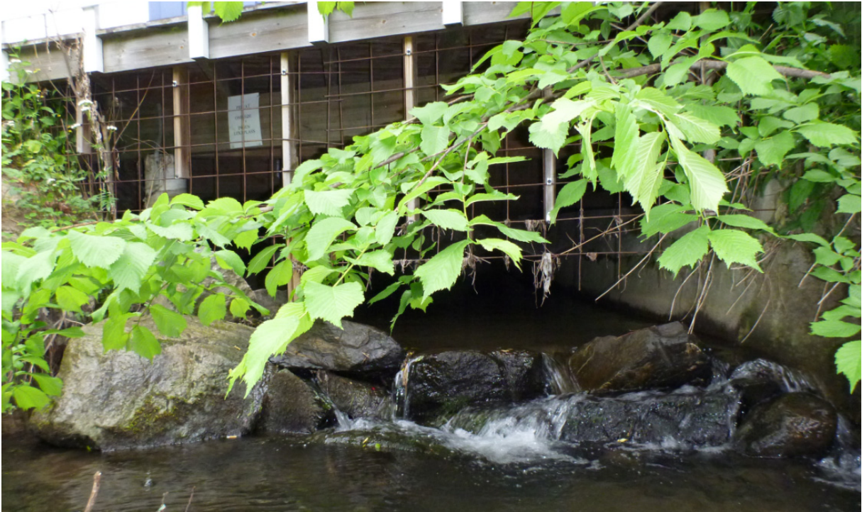
Figur 68. Steindemning nedstrøms kanalisert strekning der nederste del går under uteareal ved bolighus (3). Foto: NIVA
