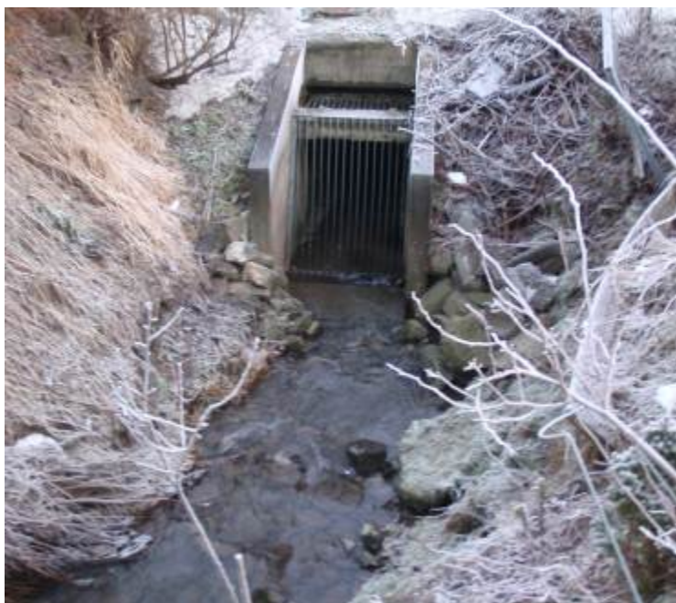
Figur 109. Tilsigsbekk Ljanselva går i vandringshindrende veikulvert under Munkerudkleiva (10). Foto: NIVA
