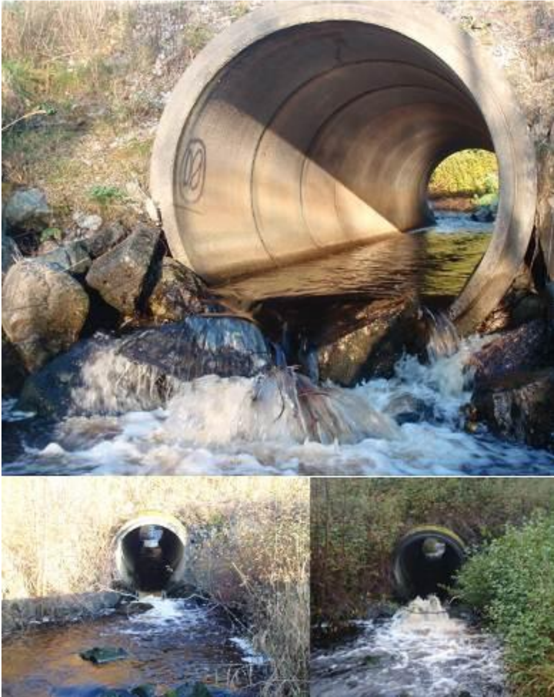
Figur 7. Kulvert under Fv 714, med utløpsenden på lav- (under, t.v.) og høy vannføring (under, t.h.).
