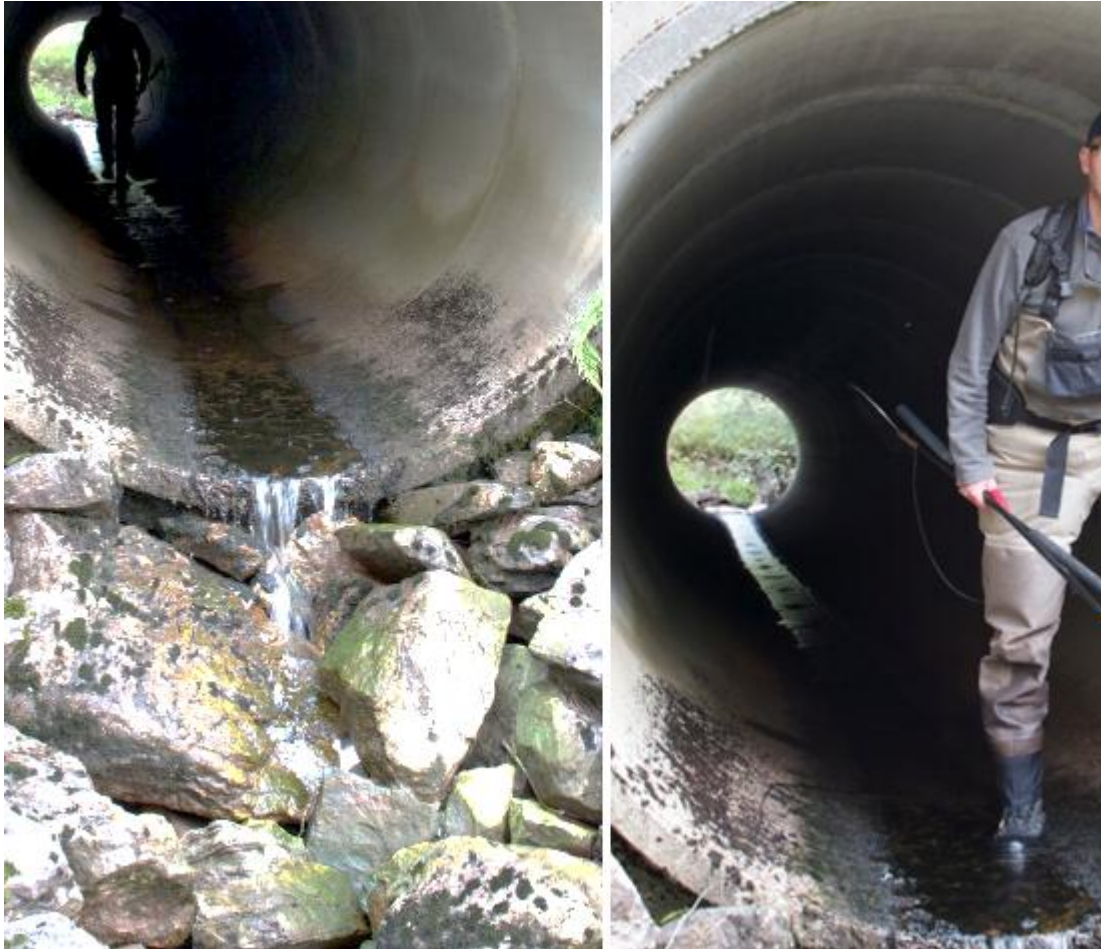
Figur 101. Kulverten under Fv 381 ved befarings på middels vannføring i august 2012. (Foto: privat)
