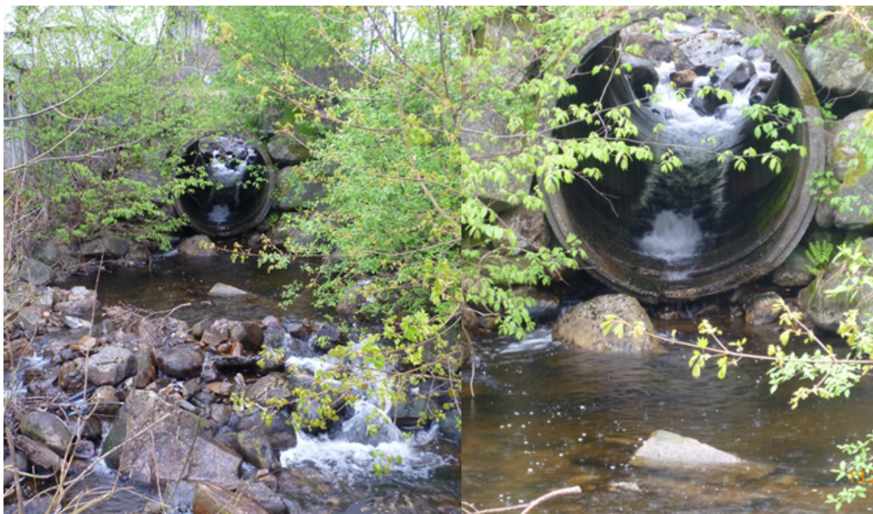
Figur 31. Kulvert under Saga er vandringshindrende, men trolig ikke en permanent vandringsbarriere. Foto: Morten Andre Bergan
