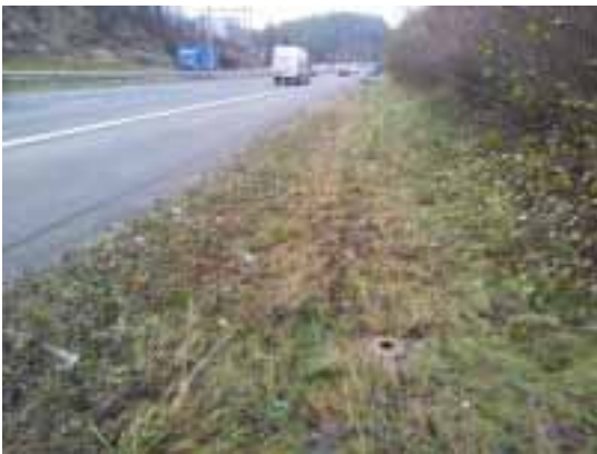
Siste sluk/sandfang før bru øst.
