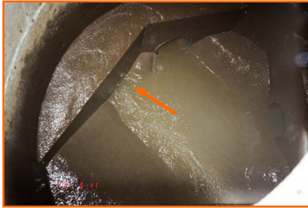
Figur 49. Avløpskummen nedstrøms Kleppestø RA. Vatn frå silane strøymer inn i kummen gjennom røyropningen til høgre. Avløpet med blå farge øvst i fotoet går til overløpet, mens opningen til det ordinære utløpet ut til 30 m djup kan skimtast om lag midt i biletet (pil). Før doseringa 19. juli var det mellombels montert eit røyrbend i overløpet, dette skulle fjernast etter forsøket. Foto: L.G. Golmen.
