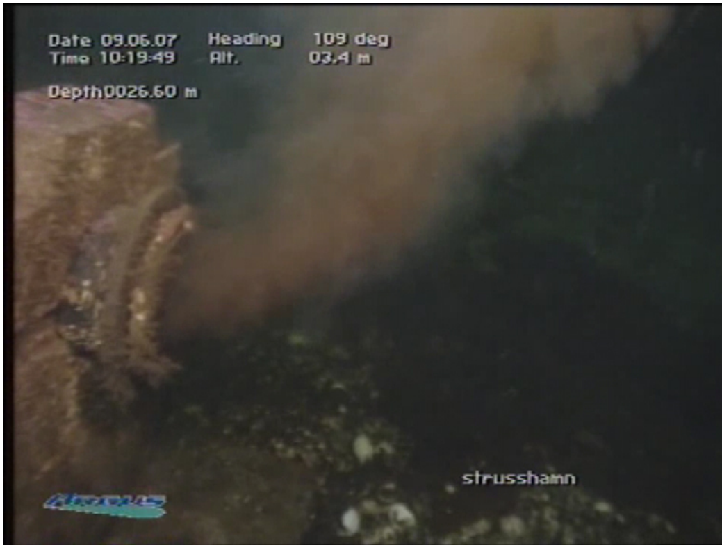
Figur 59. Strusshamn: en strøm av avløpsvann ut av hovedutløp (ledning 1)
