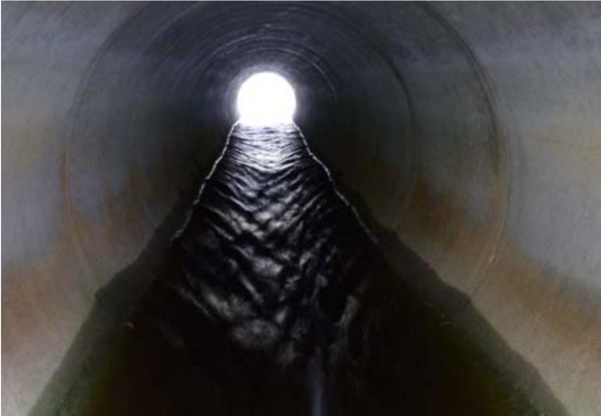
Figur 57. Krysning under Hubakkveien er ikke vandringshindrende på normale vannføringer. (Foto: Morten Bergan)
