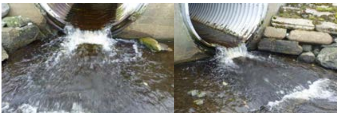
Figur 82. Veikulverten er utformet med to parallelle blikkrør, noe som ikke er en gunstig utforming mht. fiskevandring. (Foto: Morten Bergan)
