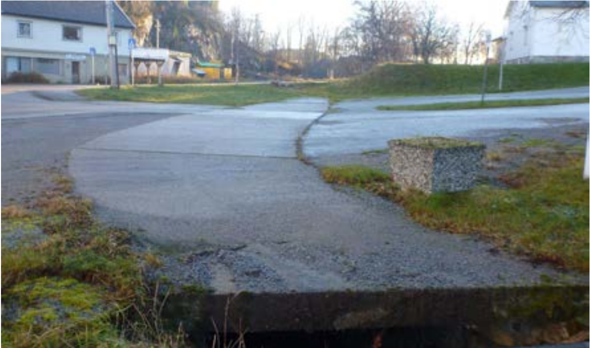
Figur 25. Lukking under Hasselvikveien er lang og vandringshindrende, men sjørret kan trolig passere i perioder med en noe høyere vannføring. Foto: Morten Bergan
