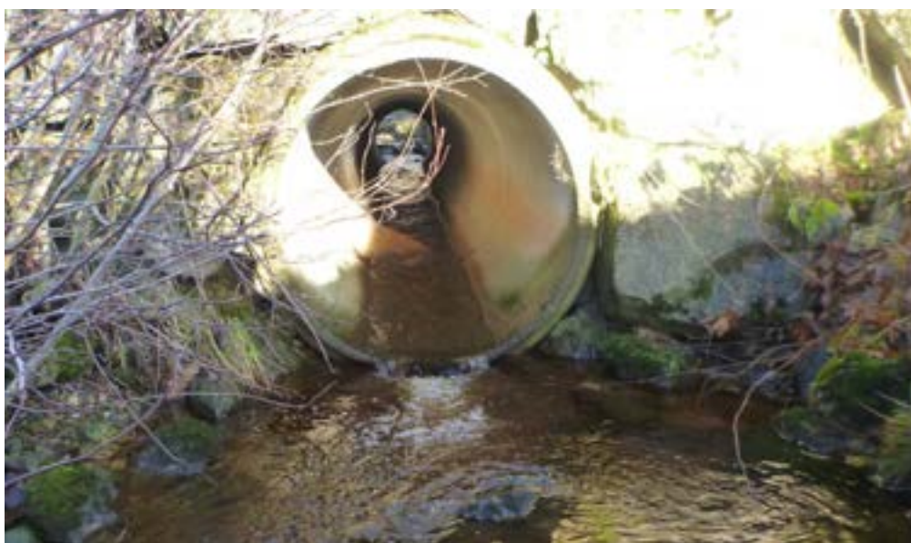
Figur 38. Veikrysning under Fv 131 for bekken fra Rotbaktjøna. Ukurant betongrør med lav vanndybde på normal vannføring. Definert som et vandringshinder for laksefisk iht. kriteriesett A i klassifiseringsveilederen. Foto: Morten Bergan.
