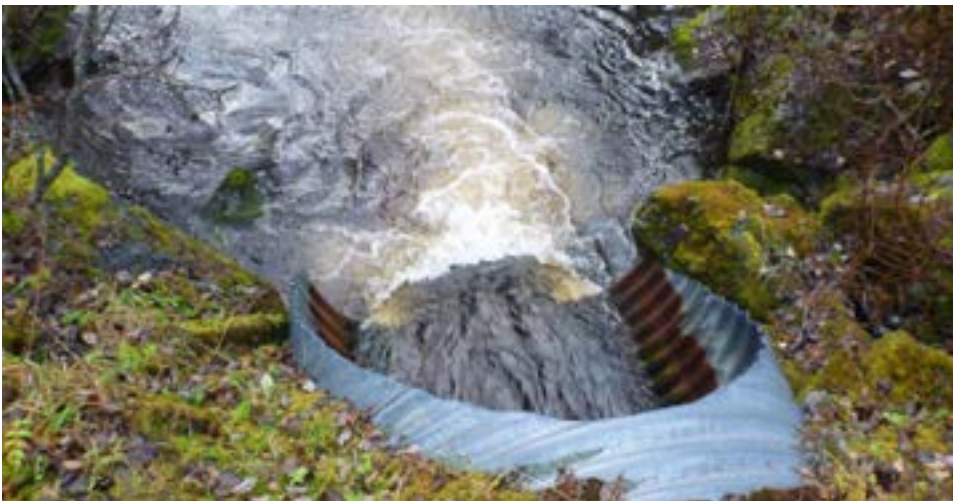
Figur 50. Kulvert under Fv 721 i øvre deler av Okla er ikke utformet på en god måte for oppgang av anadrom laksefisk, med høyt sprang og høy vannhastighet på normal eller høyere vannføring. Kulverten er passerbar for oppgangsfisk, men bør utbedres for lettere oppgang. (Foto: Morten Bergan)
