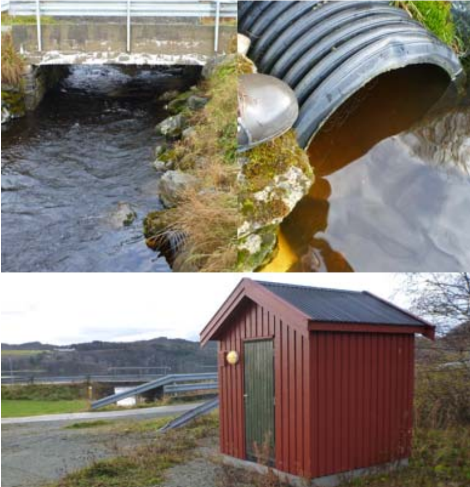
Figur 49. Utslipp eller lekkasjer av det som luktet som kloakk fra nærliggende pumpehus i nedre del av Okla. (Foto: Morten Bergan).
