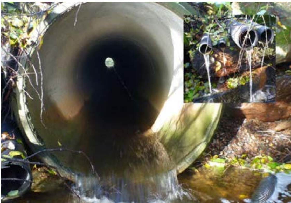
Figur 8. Kulvert under Teglverksveien i Bliksåsbekken er et vandringshindrende eller en -barriere, men bekkepartiet er allerede fisketomt som følge av kulverten under Askjemveien lenger nede. Innfelt: avrenning av ukjent art ført i rør til bekken. (Foto: M. Bergan).
