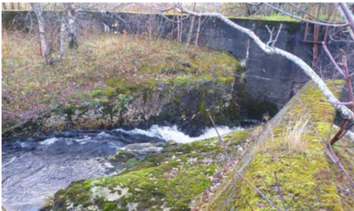
Figur 43. Eldre konstruksjon (demning) står i dag uten funksjon, men bidrar til vanskelige oppgangsforhold for anadrom laksefisk. (Foto: Morten Bergan)
