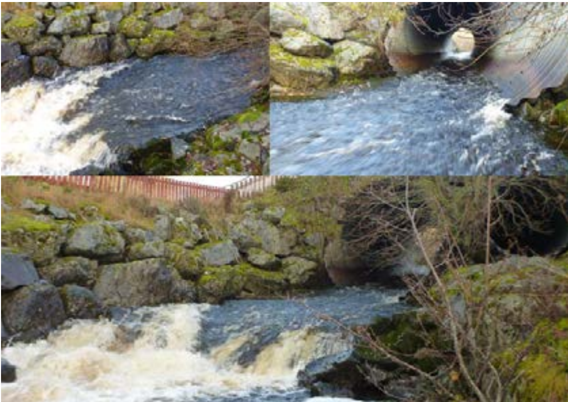
Figur 42. Oppgangsforholdene for laks og sjørret i Bottengårdselva er vanskelig sammenlignet med naturtilstand som følge av veikrysningen under Fv 710. Fisk passerer, men vandringsvinduet er betydelig innsnevret, og kan ha økologiske konsekvenser laks- og sjørretbestanden. (Foto: Morten Bergan)
