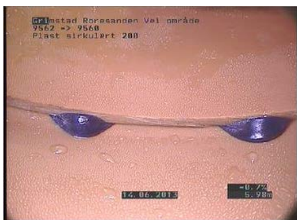
c) Synlig pakning observert ved rørinspeksjon
