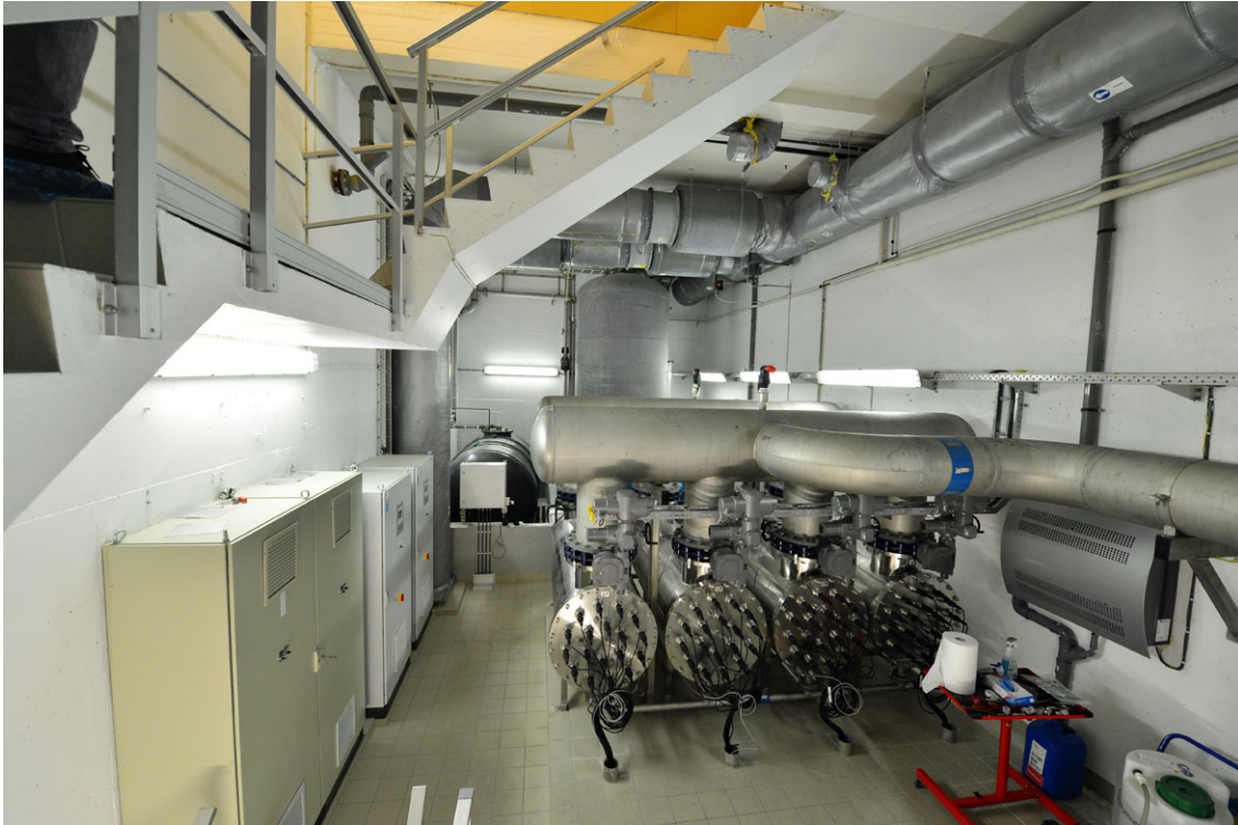
Figur 8.15. UV- anlegg ved Grimstad vannbehandlingsanlegg (Foto: Christen Ræstad)
