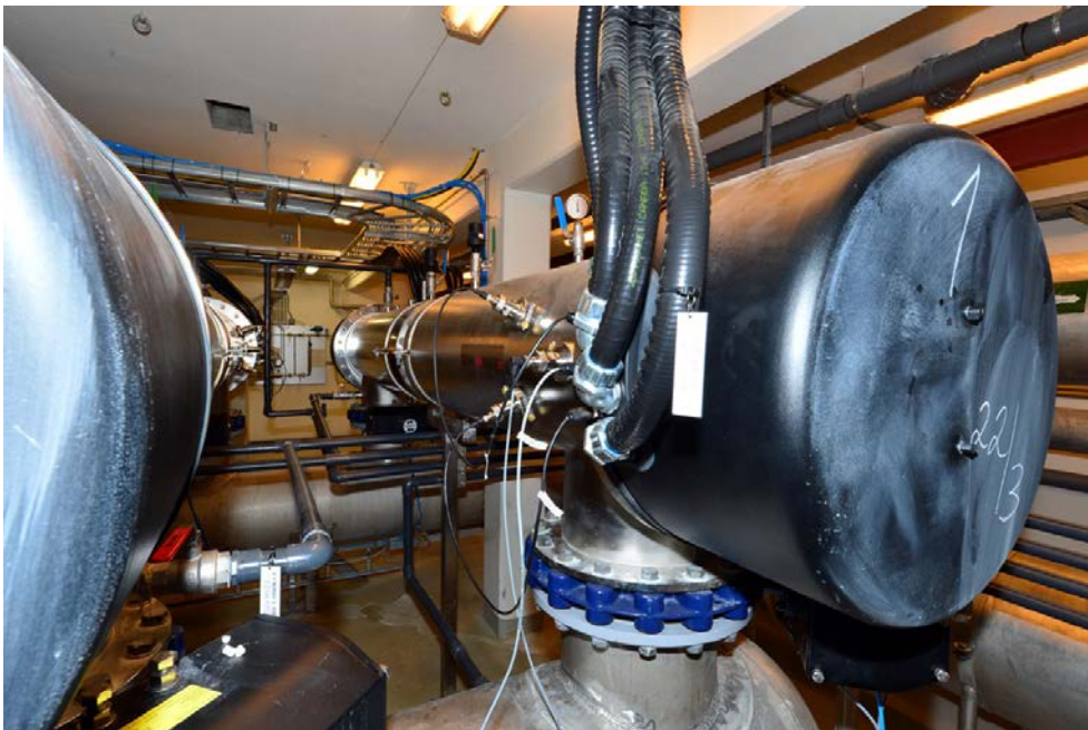
Figur 8.5. UV-aggregat (Trojan) for Arendal vannbehandlingsanlegg med 3 UV-sensorer (Foto: Christen Ræstad)
