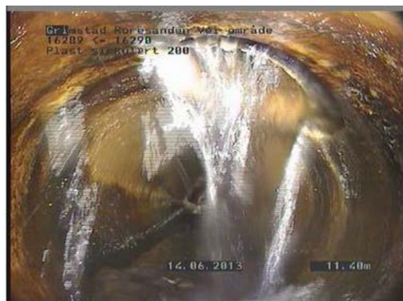
b) Innlekking av vann via forskjøvet skjøt. Mulighet for utlekking via de samme skjøter.
