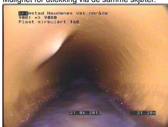
d) Eksempel deformasjon av rør, punktdeformasjon. Mest sannsynlig en stein som ligger mot røret på utsiden
