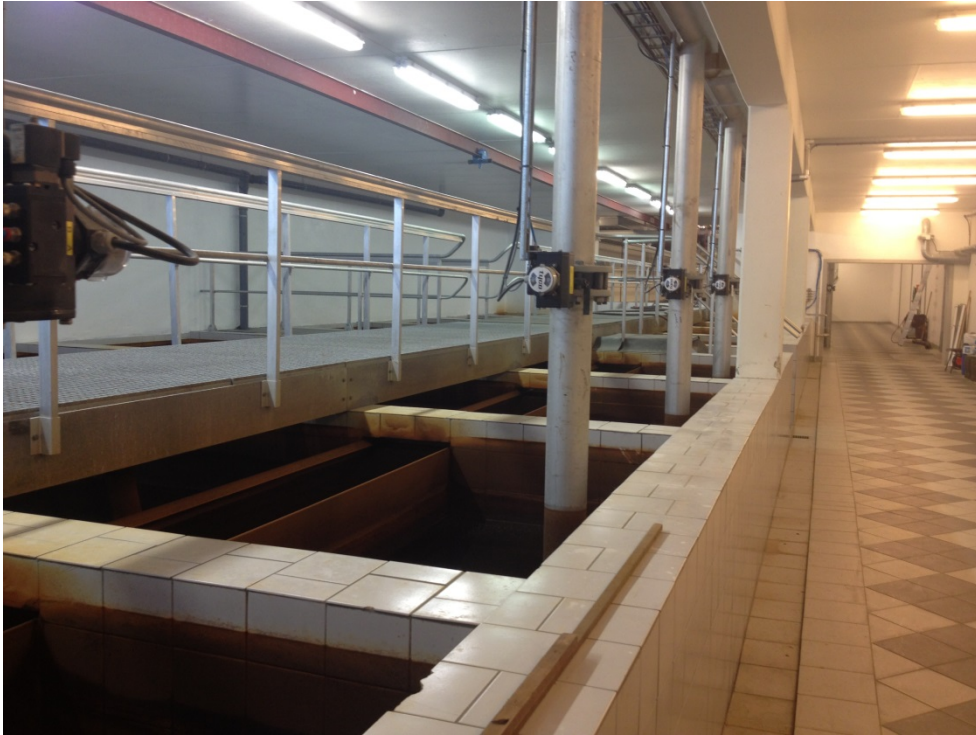
Figur 8.4. Filterbasseng ved Arendal vannbehandlingsanlegg (foto: SINTEF)
