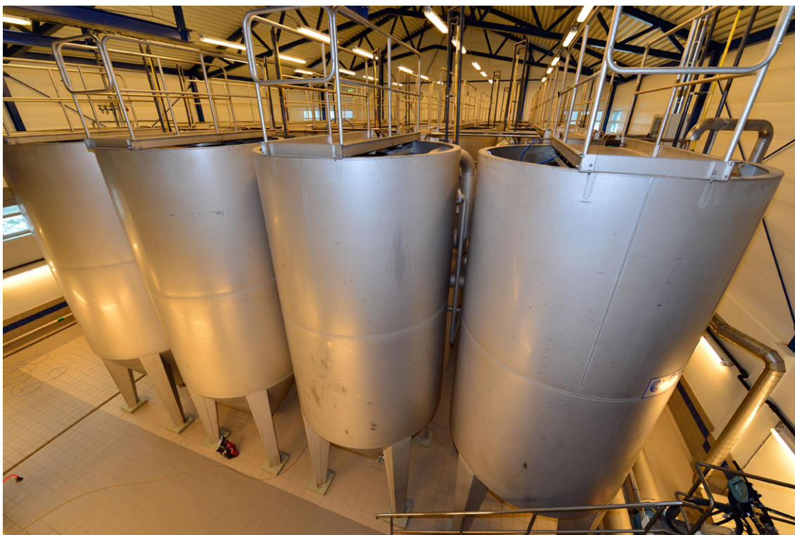
Figur 8.14. Oversikt over vannbehandlingsanlegg Dynasand filter (Foto: Christen Ræstad)
