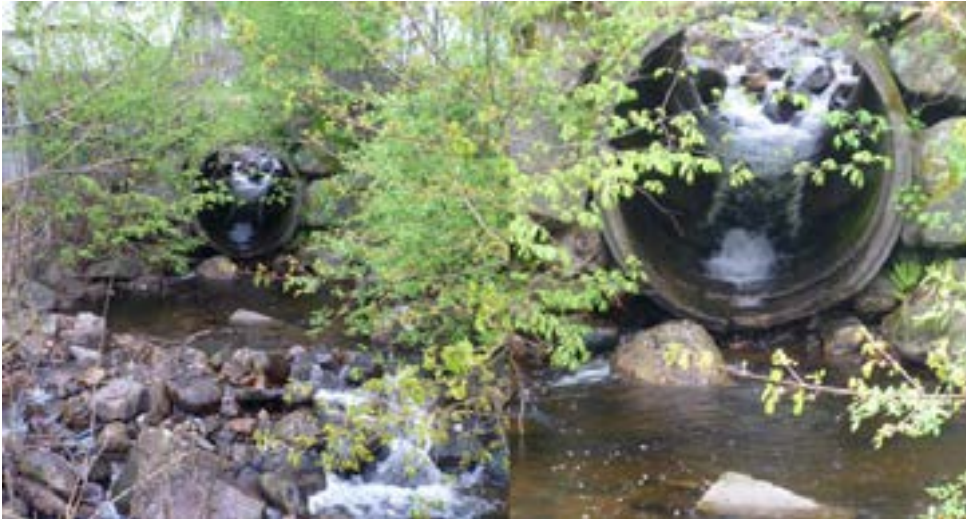
Figur 29. Kulvert under Saga er vandringshindrende, men trolig ikke en permanent vandringsbarriere. Foto: Morten Andre Bergan
