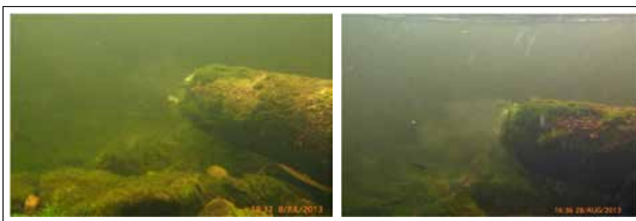
Figur 7. Nærbilder av utslippsrør fra Moøya RA i juli og aug. under normale driftsforhold i 2013. Foto: M. Bergan
