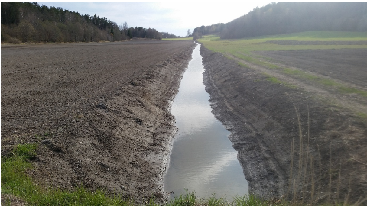
Figur 14. Grøfting av Haslebekken, fotografert april 2016 fra Skallistveien mot SV. Foto: Magne Martinsen.
