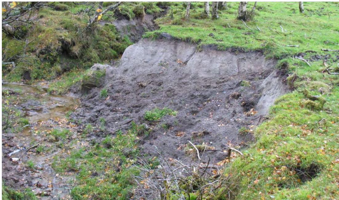
Figur 23. Erosjon og lekkasjer av sand i nedre del av Segeråga, på partier som benyttes om beiteområder av husdyr.
