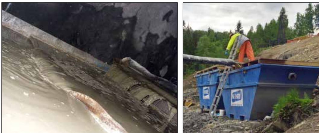
Figur 3. Koblinger mellom sedimentasjonsbassengene S1-S2 (til venstre) og S4-S5 (til høyre).
