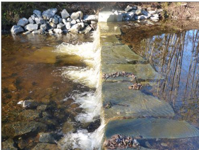
Figur 21. Det ble etablert en fiskesperre i Tømra, en tilløpselv til Selbusjøen, høsten 2014 for å hindre oppvandring av ørekyte og gjedde. Dersom den fungerer etter hensikten kan det være aktuelt å bygge en noe liknende fiskesperre i Låbekken. (Foto HBE).
