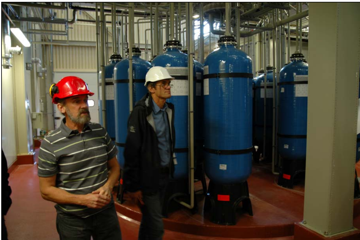
Figur 2. Renseanlegget ved gruva i Falun
